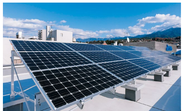
太陽光発電パネル（中津川支店）
