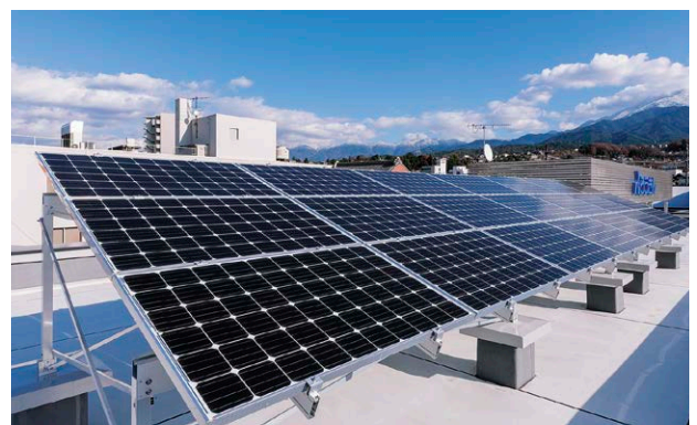
太陽光発電パネル（中津川支店）
