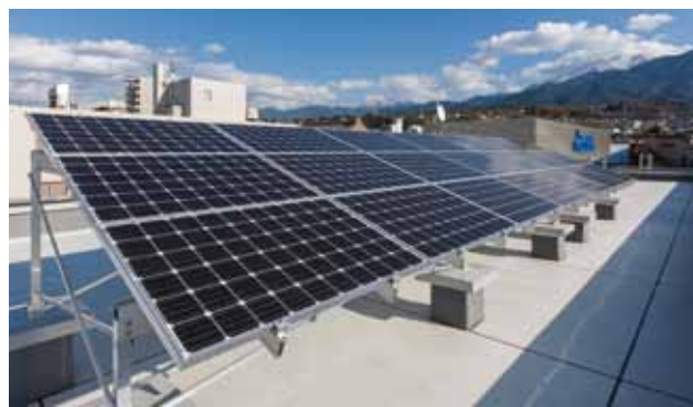
太陽光発電パネル(中津川支店)
